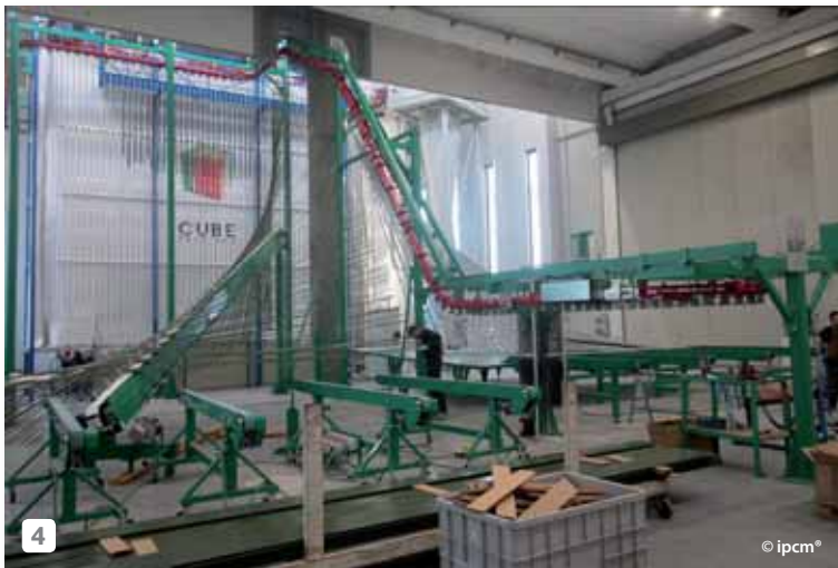
4 La planta CUBE de SAT recientemente instalada. O sistema CUBE da SAT recém-instalado.
