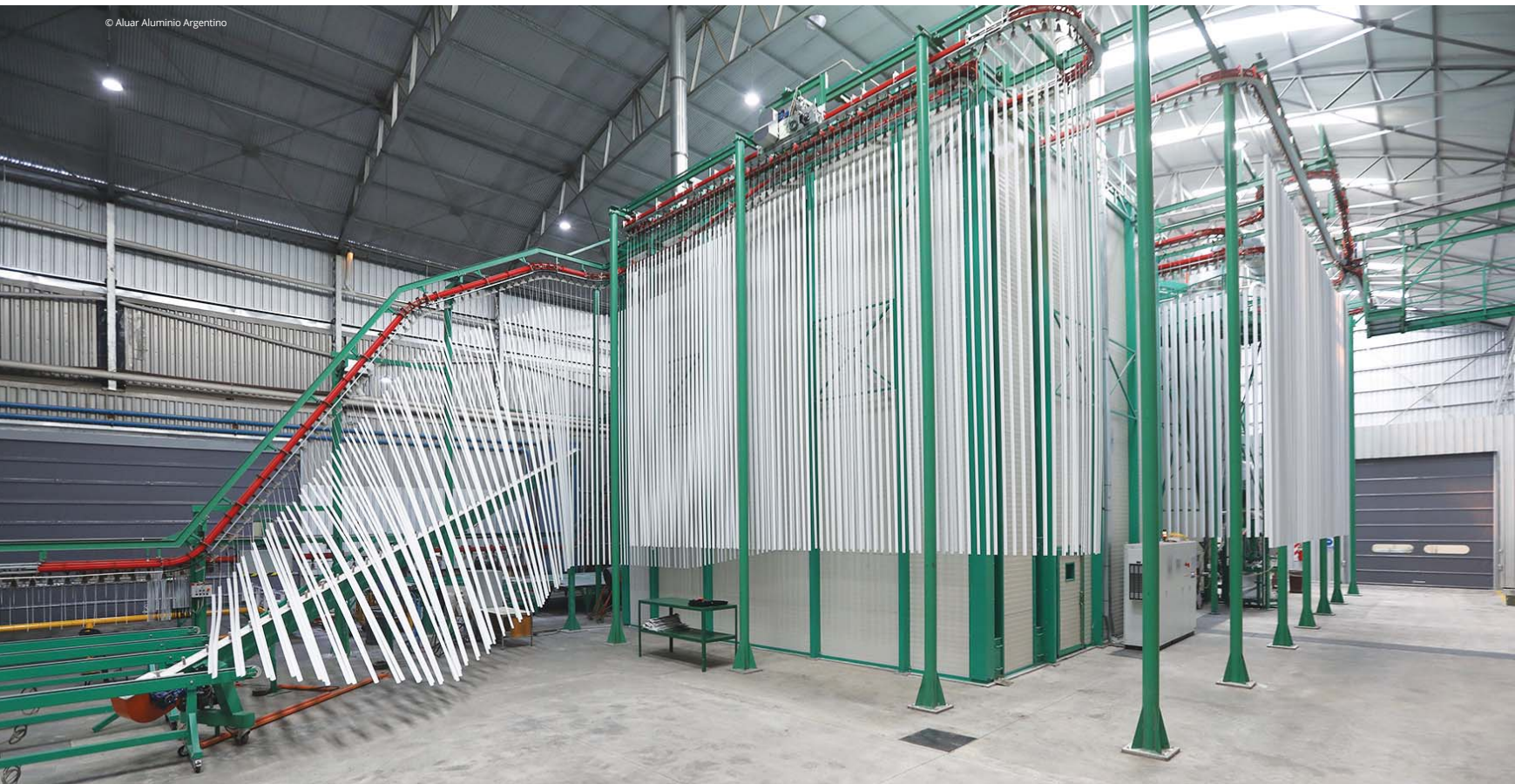
Vista general de la instalación vertical de SAT. Vista geral do sistema vertical da SAT.
