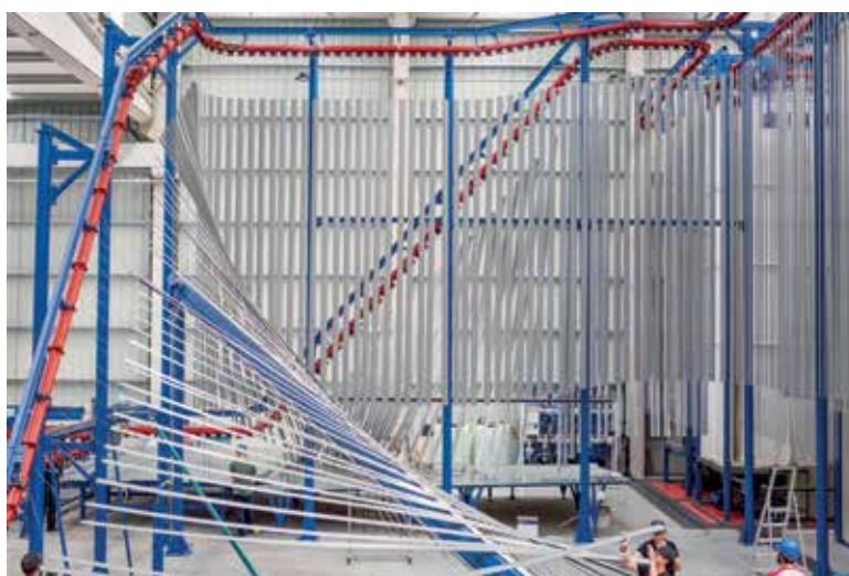
Profili di alluminio allo scarico in un impianto compatto Cube
